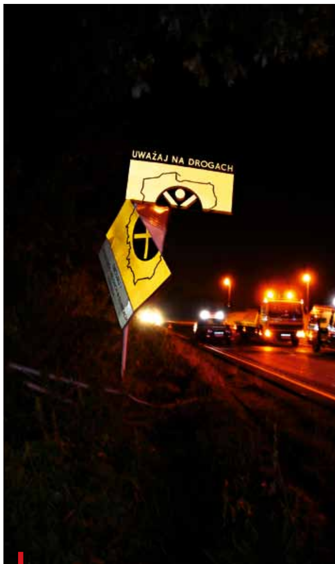
Zniszczona tablica ostrzegawcza na DK 88
